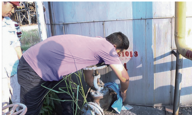
广州榕泰实业股份有限公司车间员工不知邻二甲苯危害，脱下衣服对泄漏口缠绕
