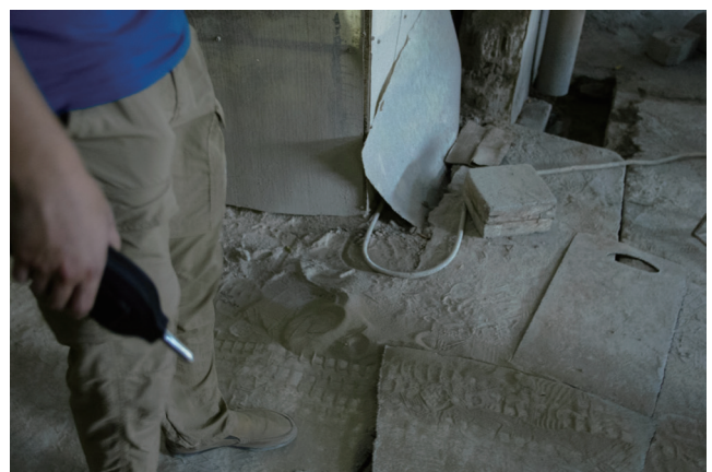
车间粉尘严重超标，作业岗位积尘严重
