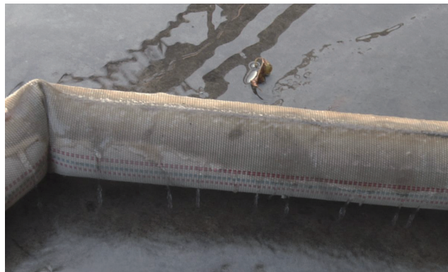
广州榕泰实业股份有限公司消防水袋到处漏水
