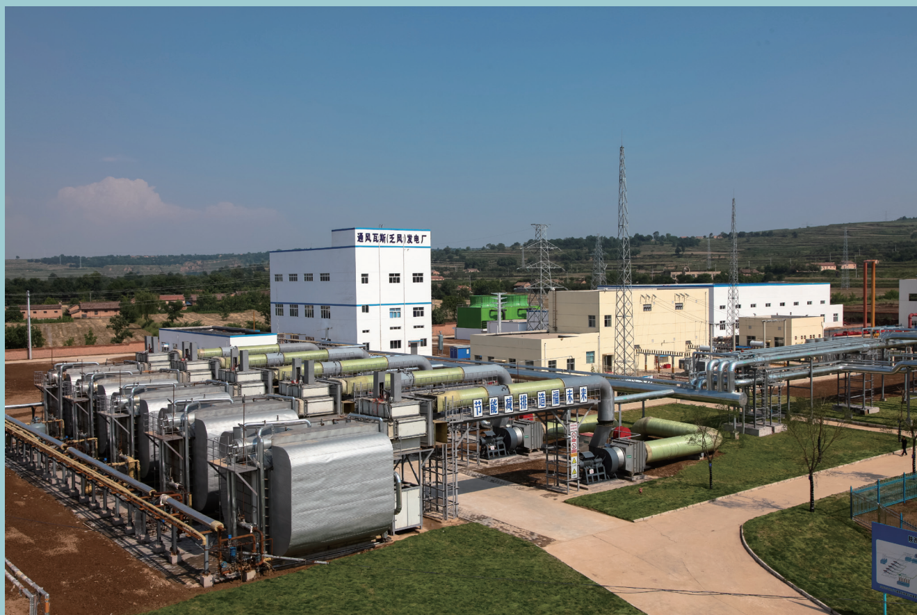
陕煤化集团大佛寺通风瓦斯（乏风）发电厂
