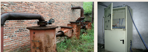
早已停用的生锈的抽排管和早已损坏的抽排泵房控制柜
